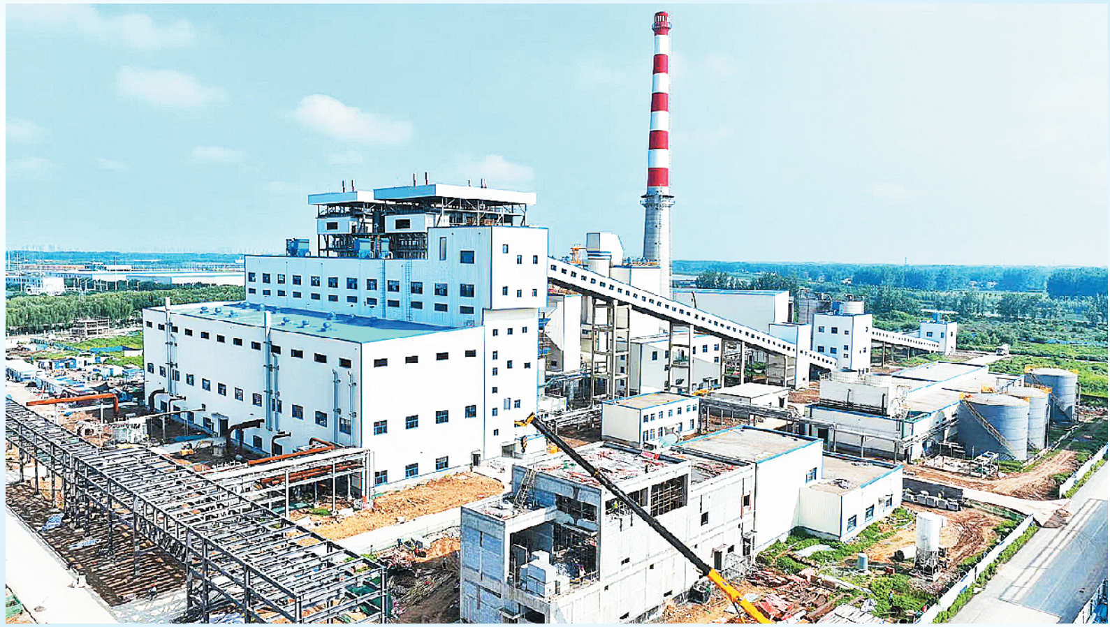
近日,全市2023年第二季度“三个一批”重大项目观摩宣讲活动走进周口临港开发区。作为本次观摩的重点项目之一,周口港口综合物流园区热电联产项目已进行单机试产。项目建成投产后,预计可实现年产值15亿元,可安置就业人员近80人。
